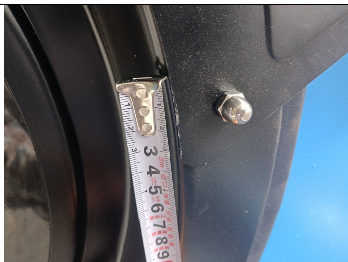
Pintura em mau estado na porta (35 mm) - Pequeno problema
